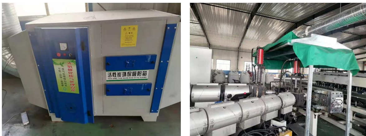
图 3-1 废气处理设施
